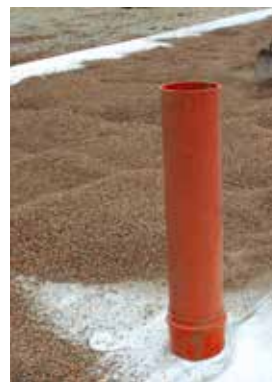
Vertikālās pārbaudes caurules daļa virs zemes, DN/OD 200 mm.
